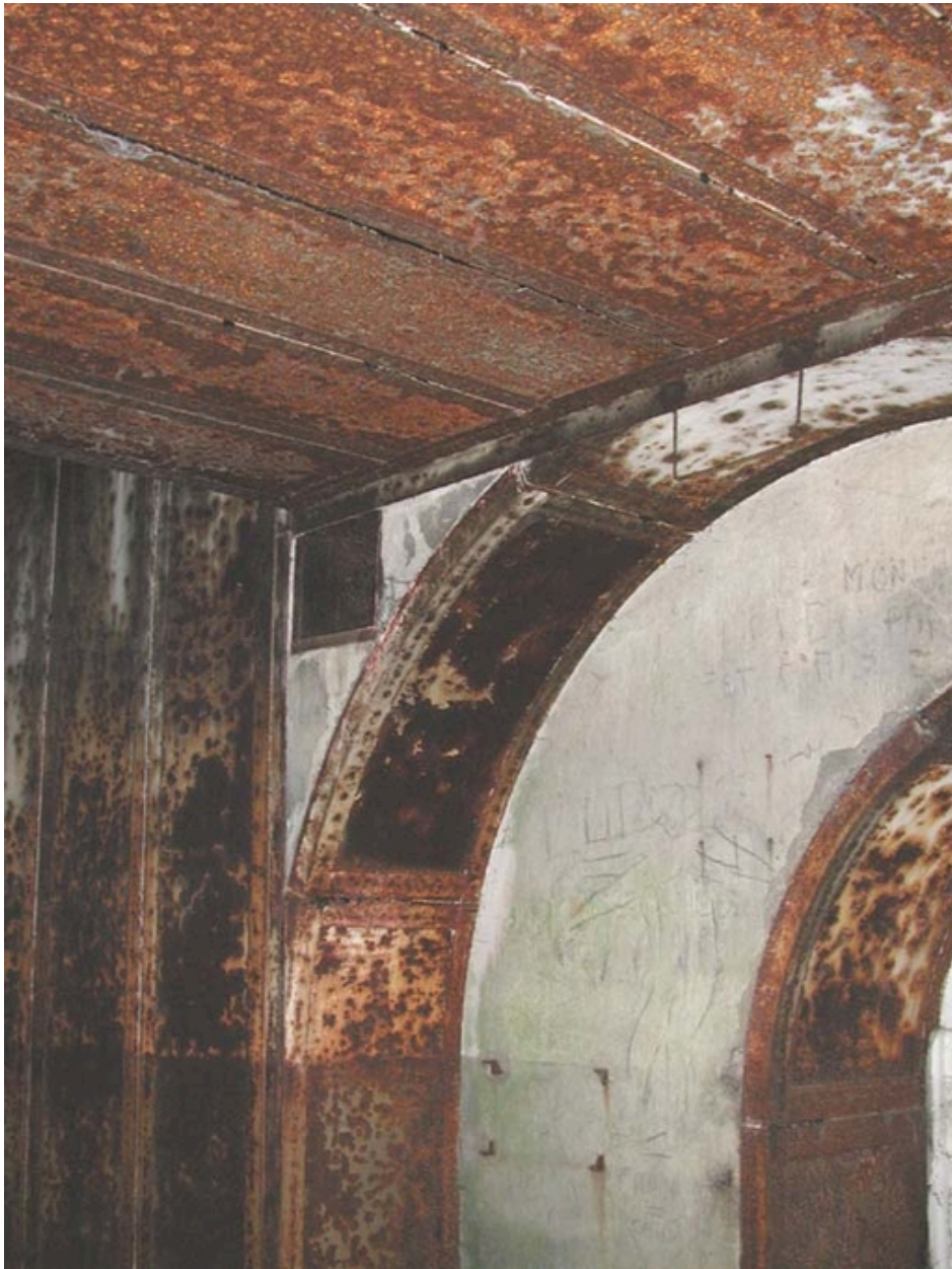
L'habillage en tôles d'acier de la chambre de tir.
