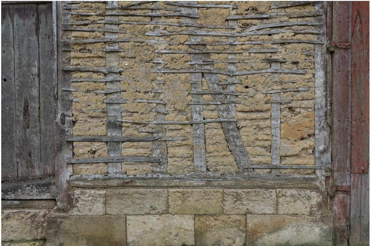
Détail de la mise en œuvre du solin et du torchis pan de bois, grange au n°41 Grande Rue.
