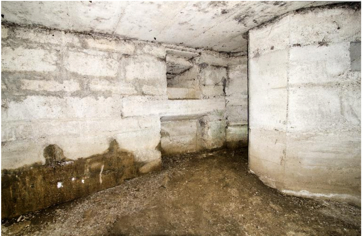
Salle nord vers le nord-est. Entrée du couloir en chicane et créneau de fusillade (au grand angulaire)
