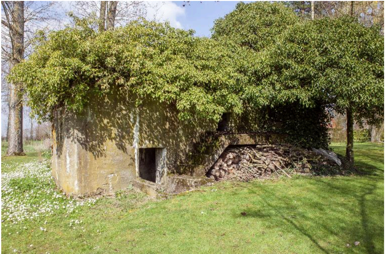
Vue générale vers le nord : accès à l'édifice et escalier menant au poste de mitrailleuse
