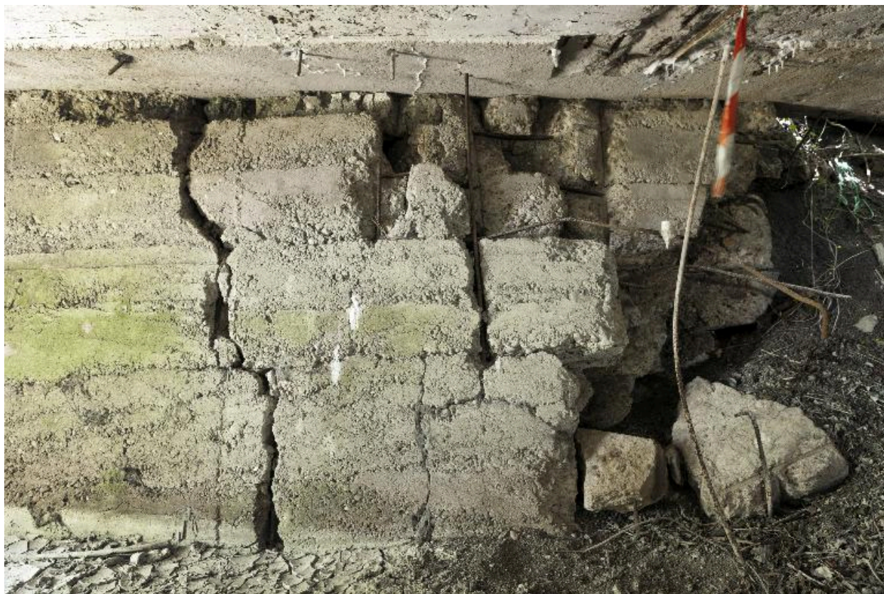
Partie du mur ouest, effondrée
