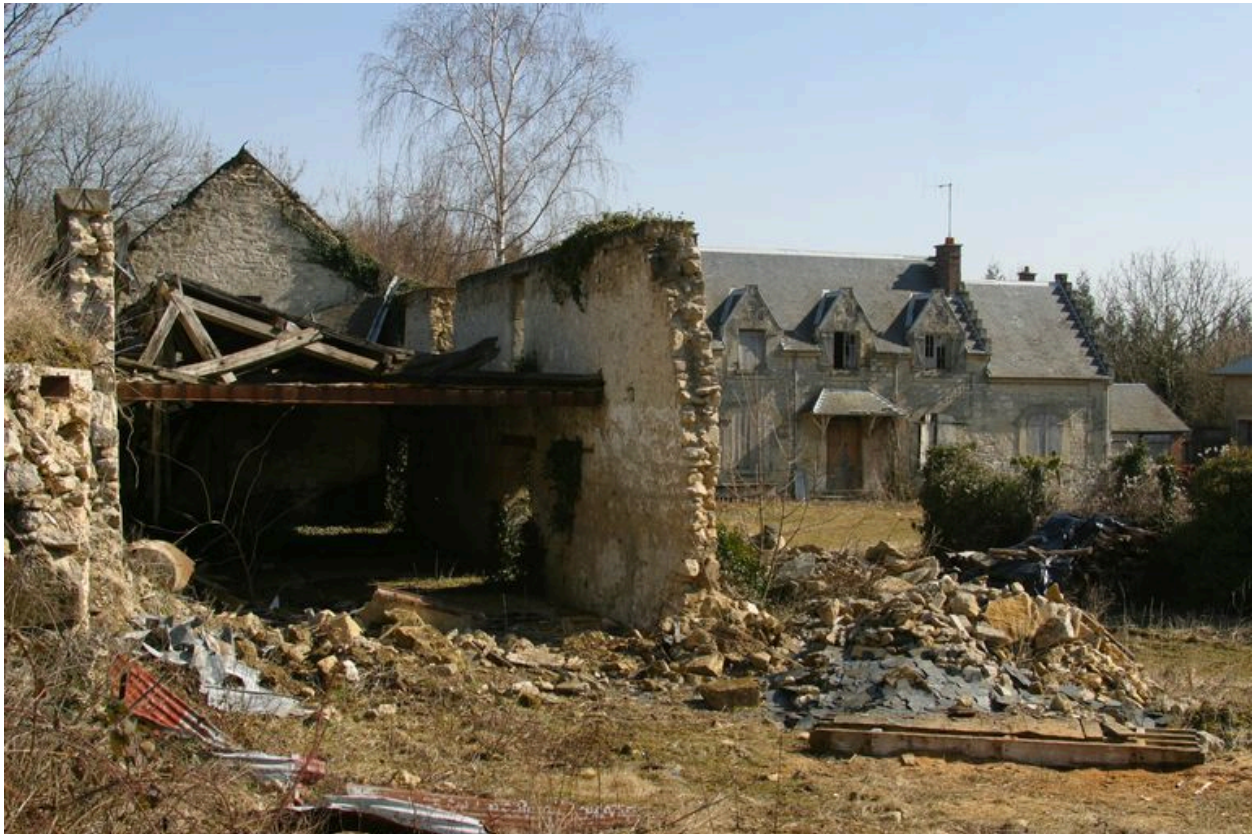
Vue des bâtiments agricoles actuellement en ruines.
