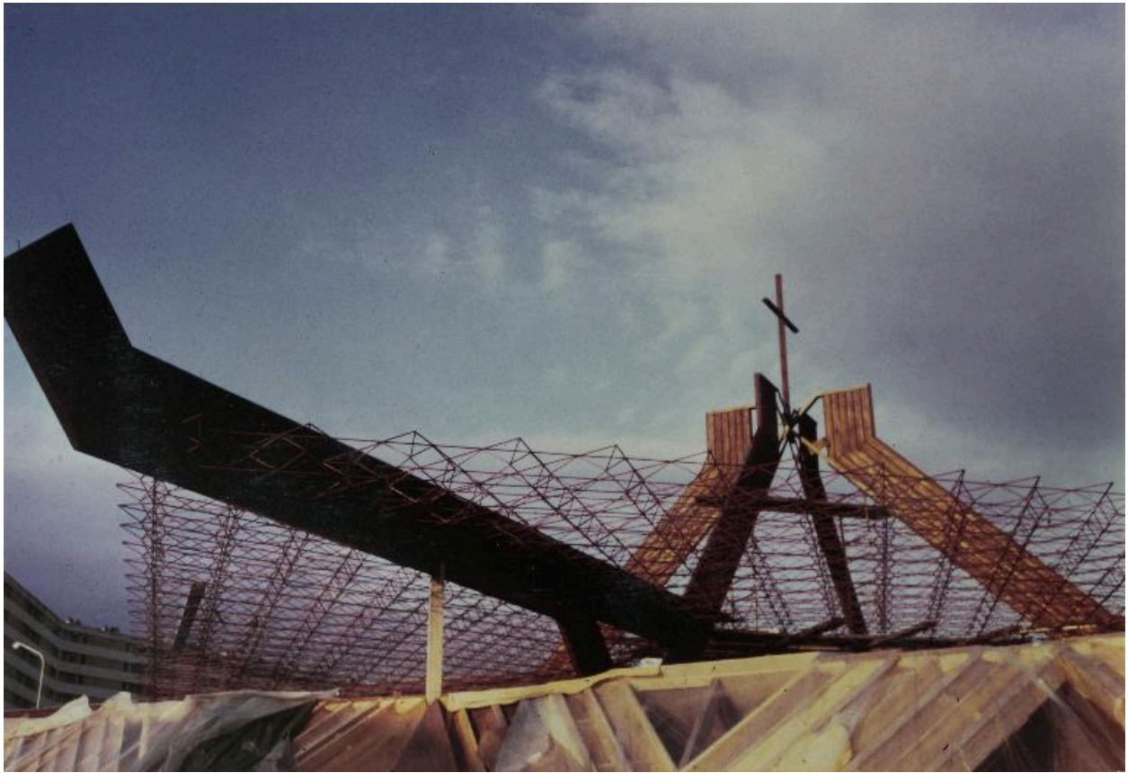
L'édifice en cours de construction. Vue de la charpente et du clocher horizontal. Photographie, vers 1970. AP Jean XXIII, Saint-Quentin.
