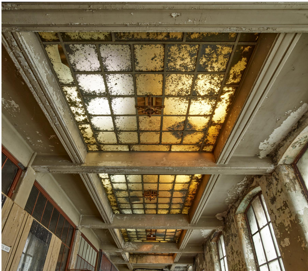
Salle des générateurs électriques, détail du plafond en béton et verre cathédrale.
