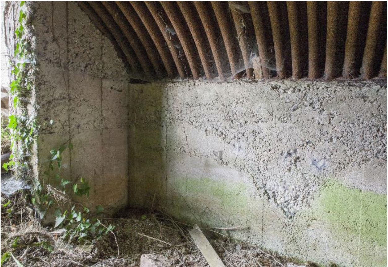
Vue intérieure de la casemate à munitions, probablement celle de la position II sur les document britanniques
