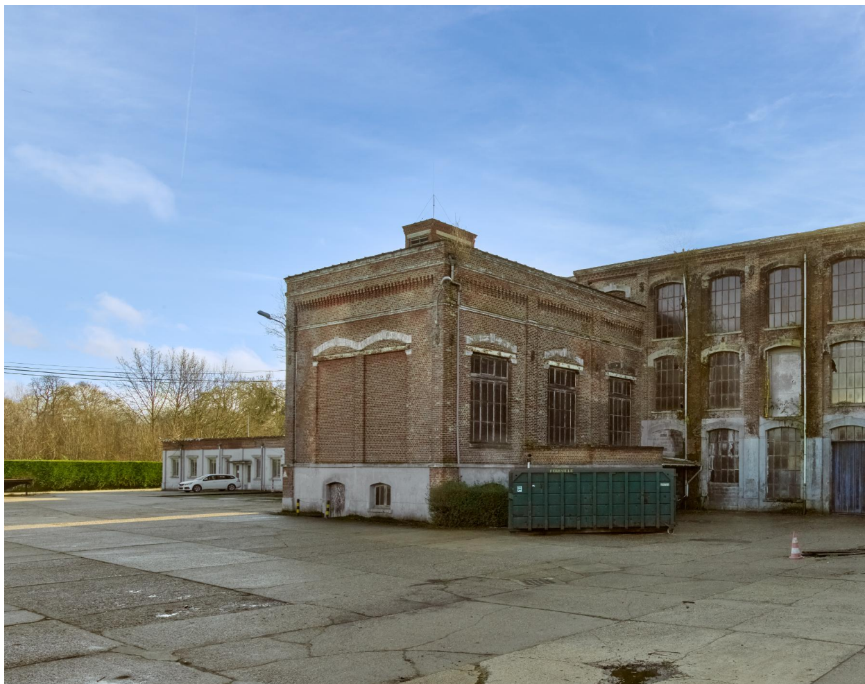
Vue générale nord-ouest de la salle des machines attenante à l'atelier de fabrication.
