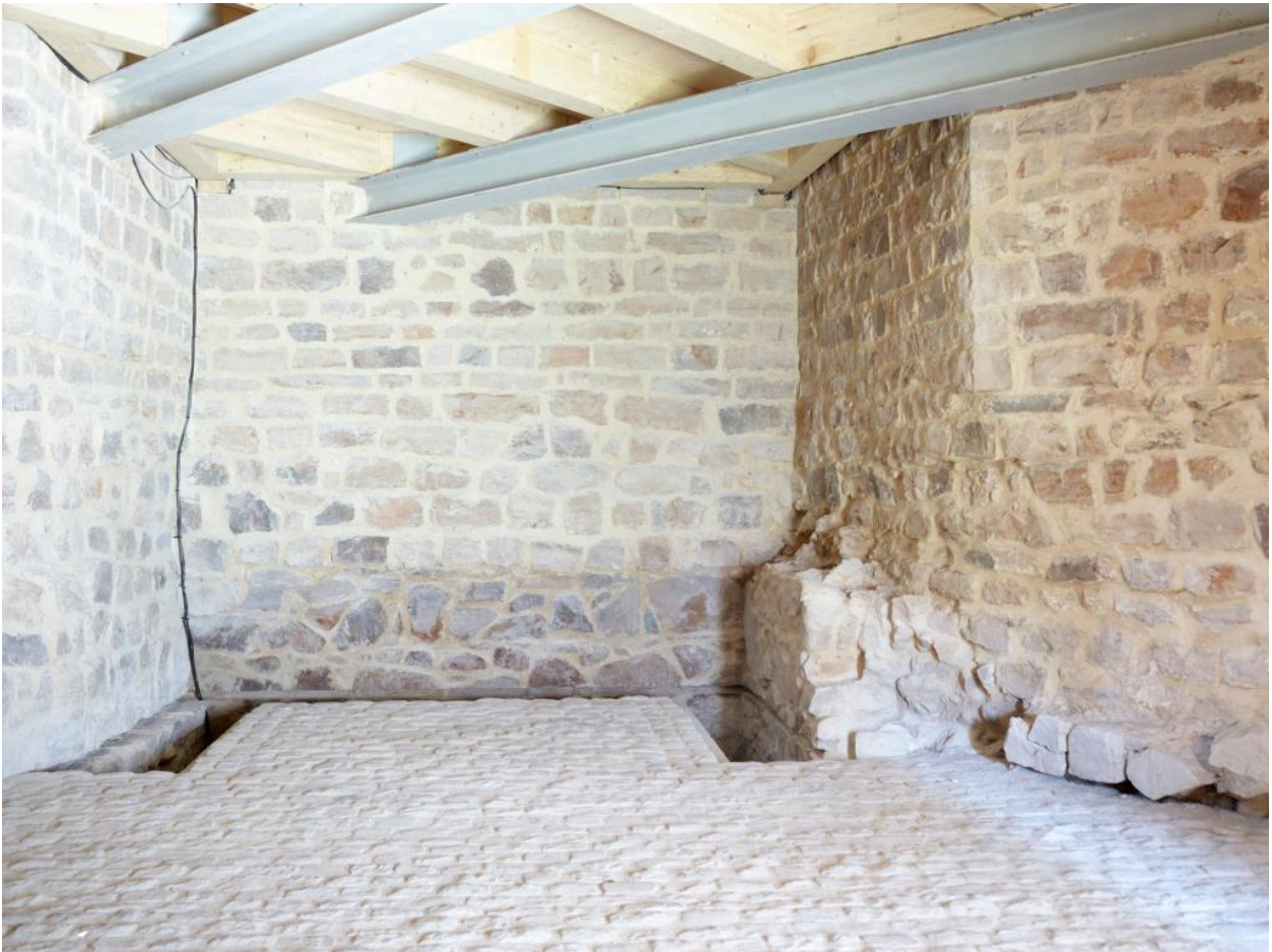
Vue de détail du rez-de-chaussée, vestiges des fondations médiévales des fortifications de Béthune.
