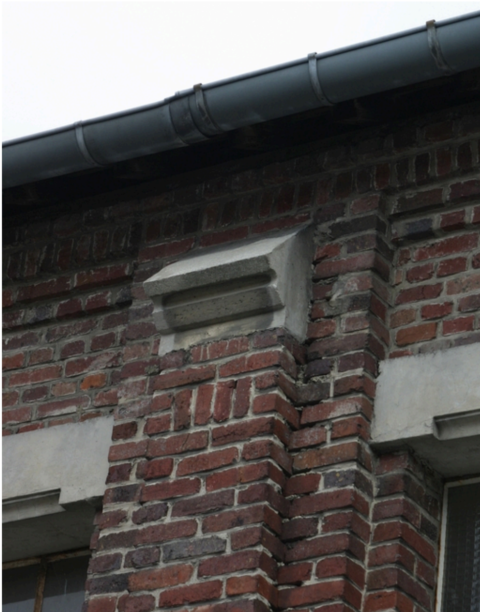
Façade occidentale de l'un des deux grands ateliers de guipure reconstruits à partir de 1919 : détail.
