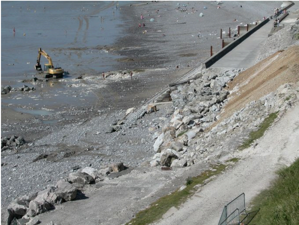
La digue détruite lors d'une tempête en 2005.
