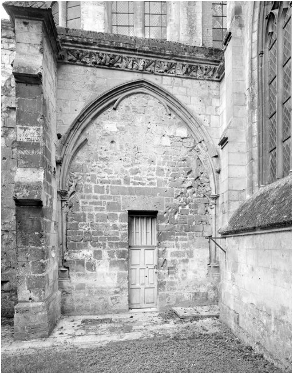
Le cloître. Elévation extérieure de la seule travée conservée de la galerie est.
