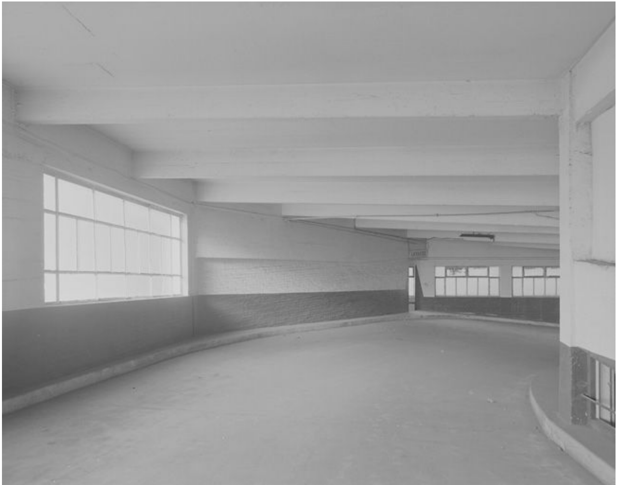
Vue d'une partie de la rampe d'accès entre le niveau 2 et le niveau 3.
