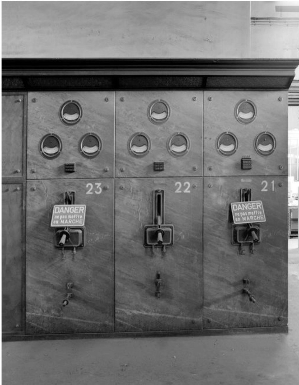
Armoire électrique en 1988.
