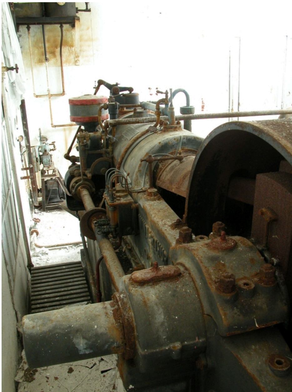
L'un des deux moteurs de la machine : au premier plan, l'axe du volant.
