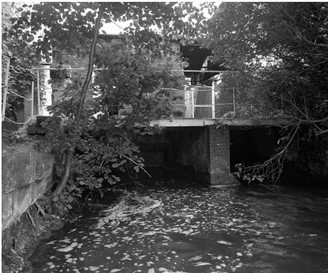
Le Thérain passant sous la salle des machines.
