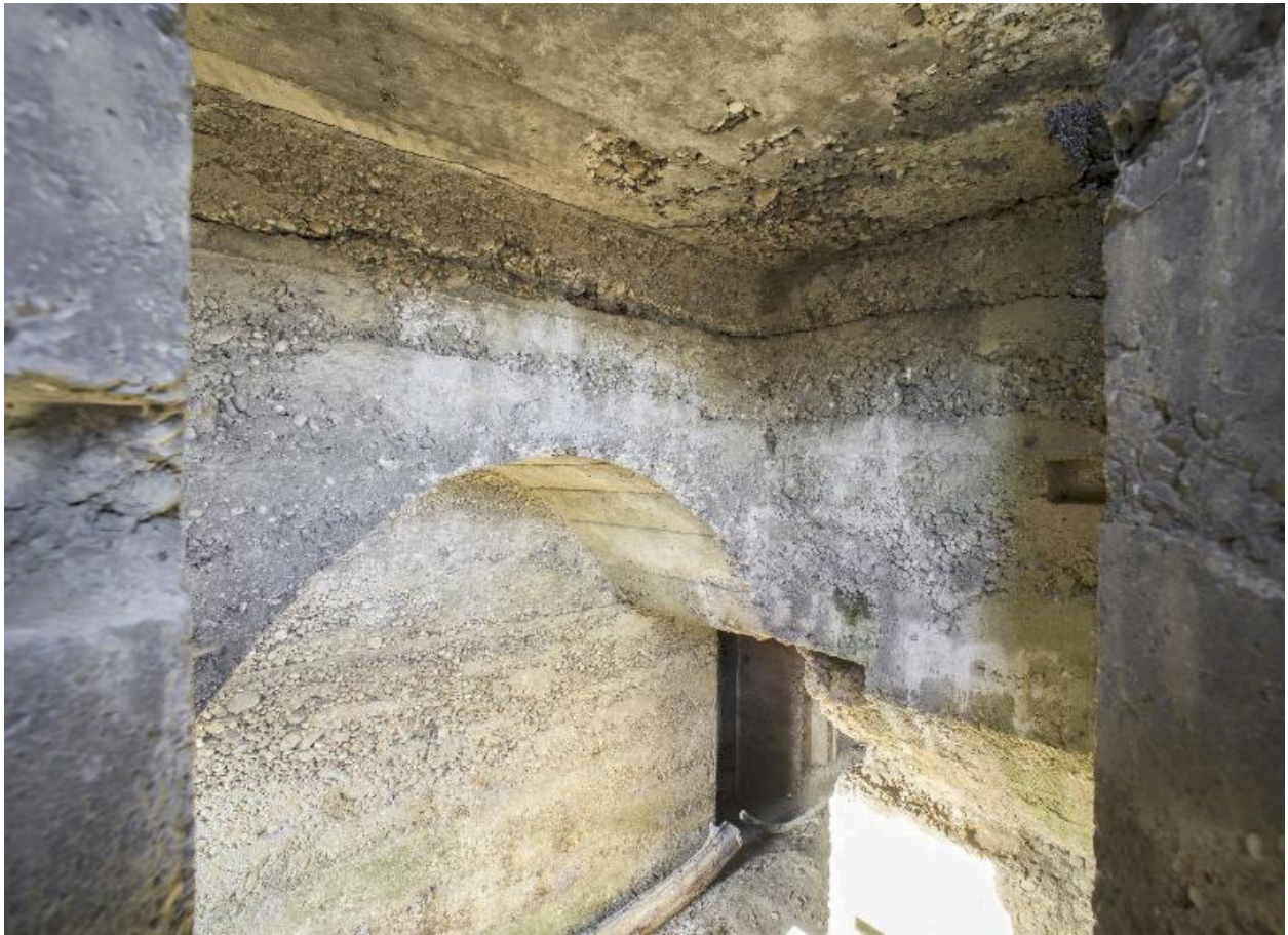
Sortie du poste d'observation vers le couloir de distribution (au grand angulaire)
