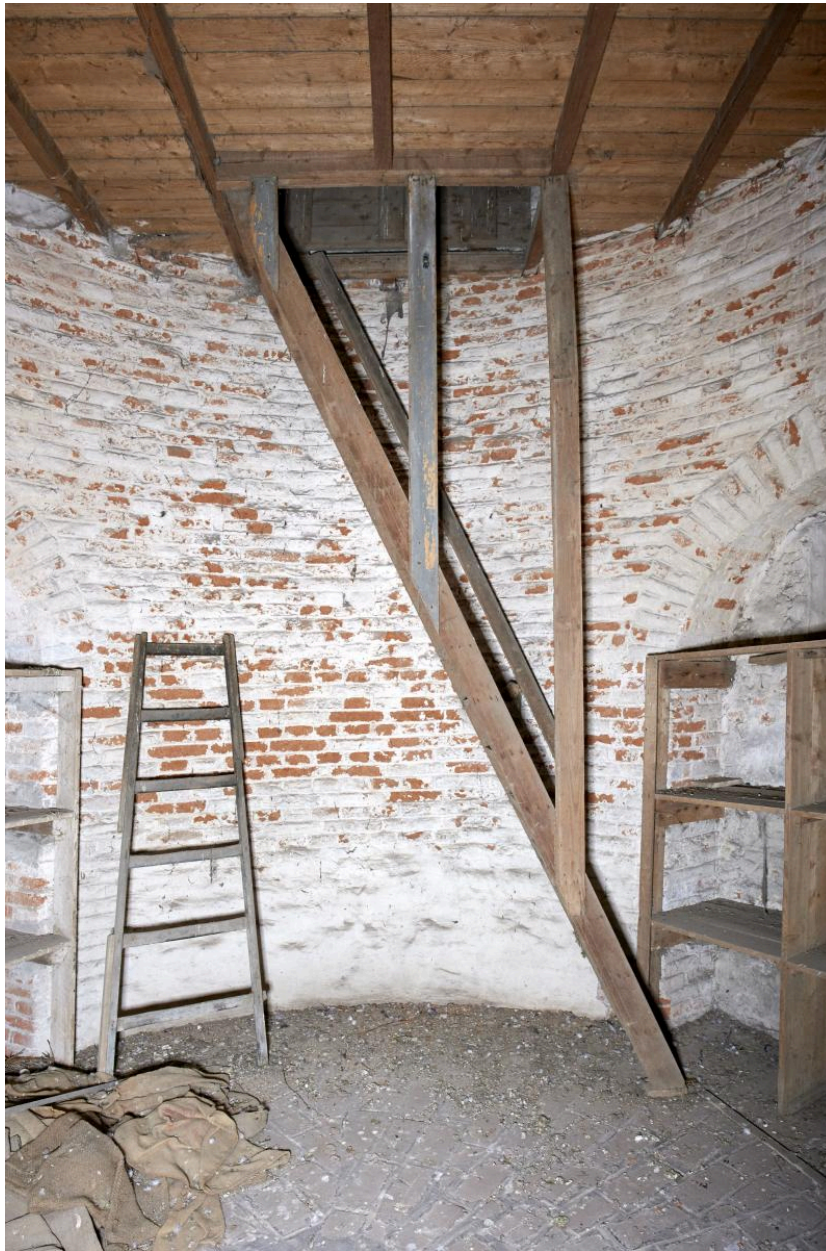
Chemin de ronde. Salle circulaire interne. Echelle de meunier menant à la tour de guet (niveau supérieur).
