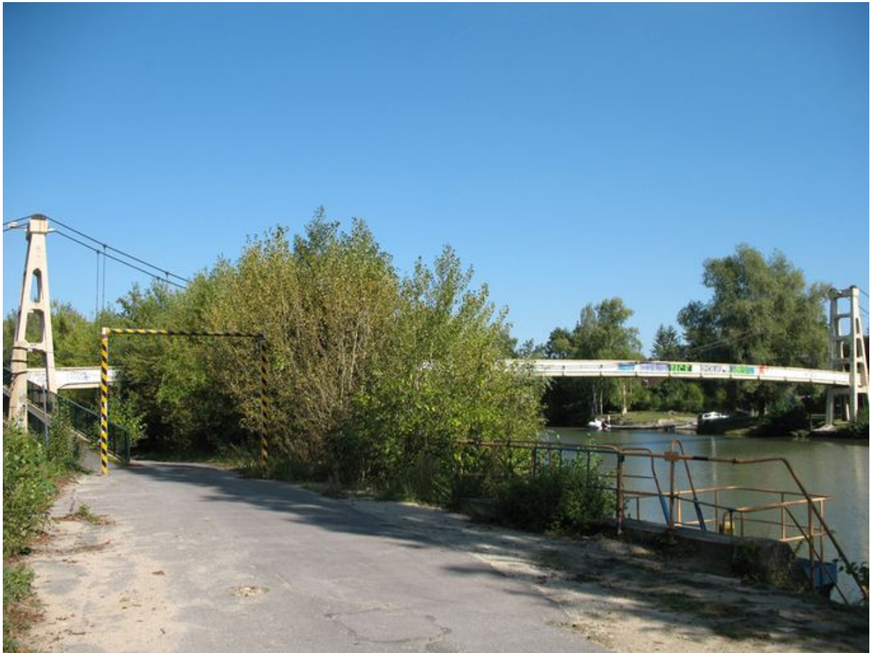
Vue générale de la passerelle depuis la rive droite (Villers-Saint-Paul) de l'Oise.
