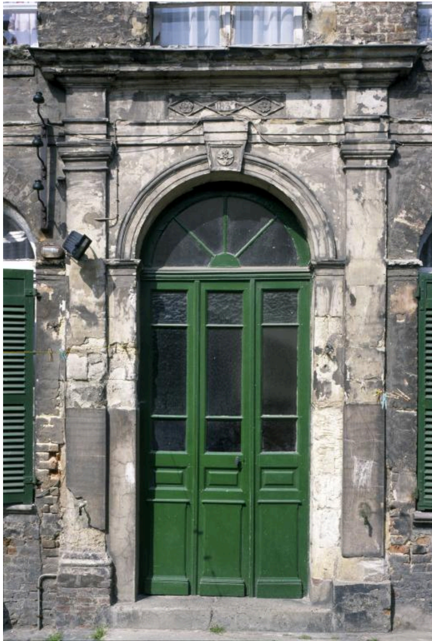
Vue de la porte d'entrée du bâtiment principal sur cour, portant la date de 1835.
