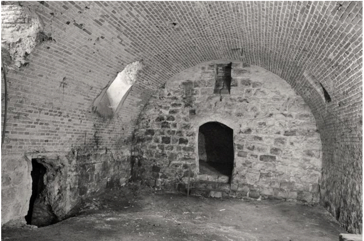
Vue générale du 1er niveau de cave, couvert d'une voûte en berceau plein-cintre en brique.
