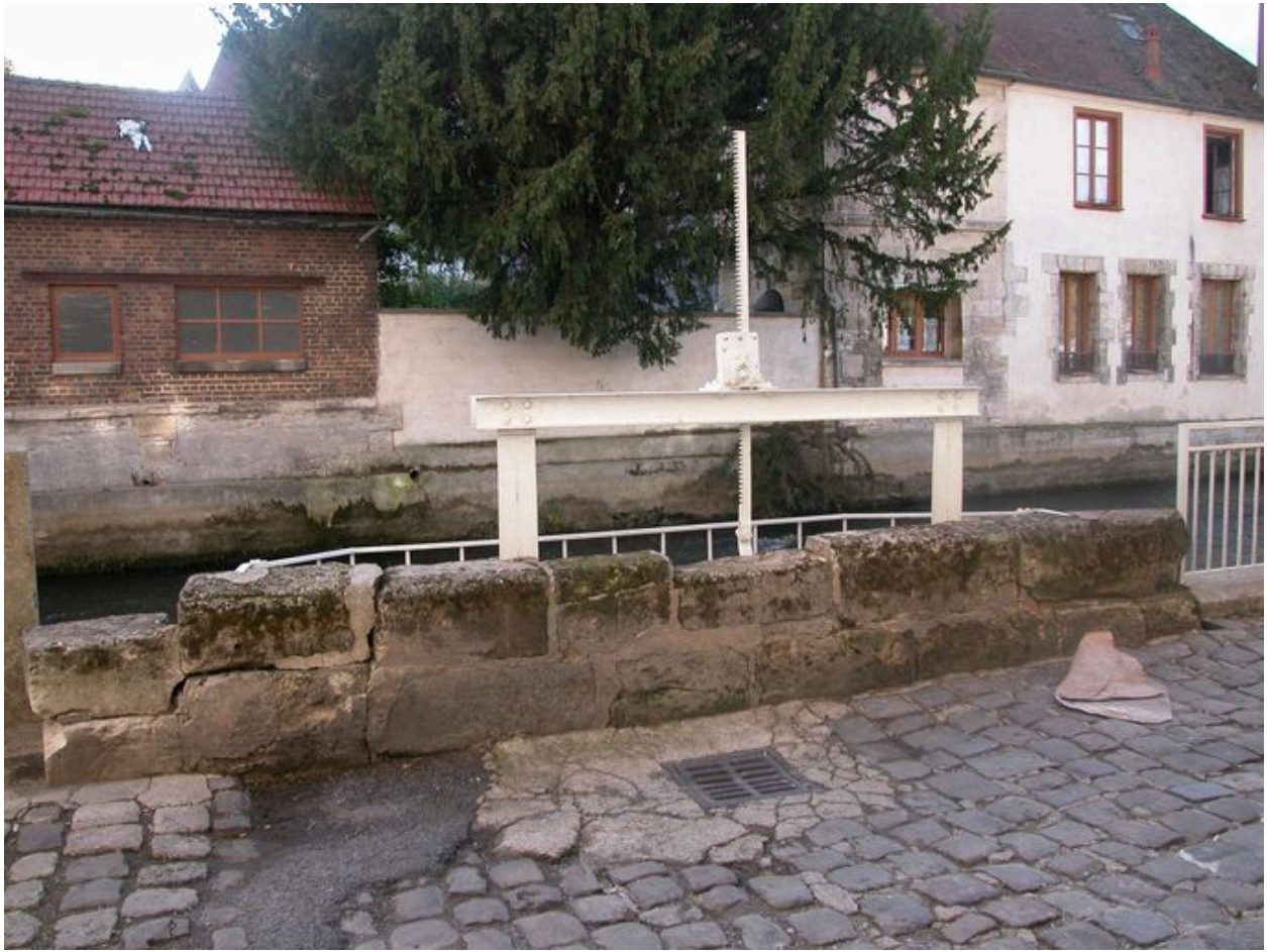
Vanne du canal de dérivation.
