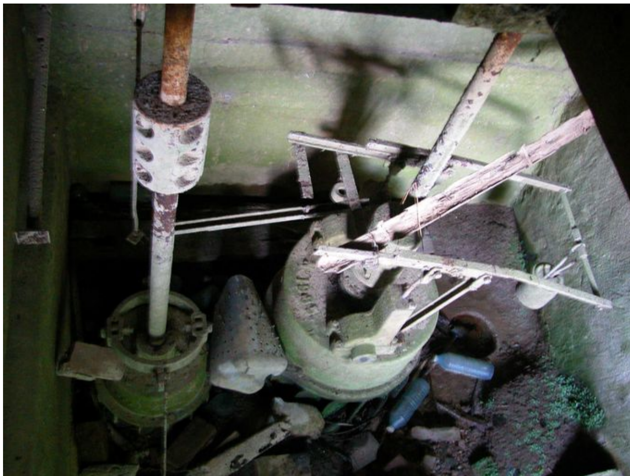
Vue de dessus des deux turbines.
