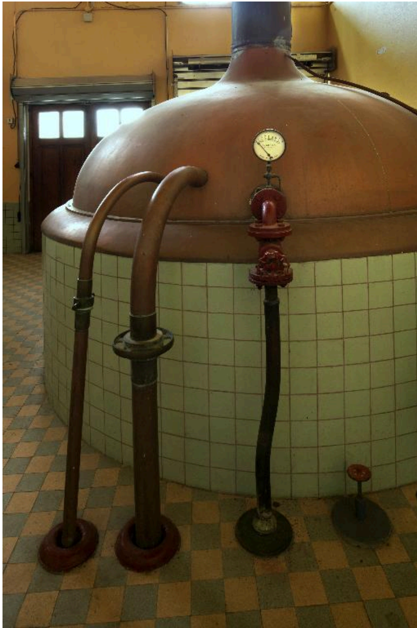
Détail des tuyaux et du manomètre Diebold de l'une des cuves de brassage.
