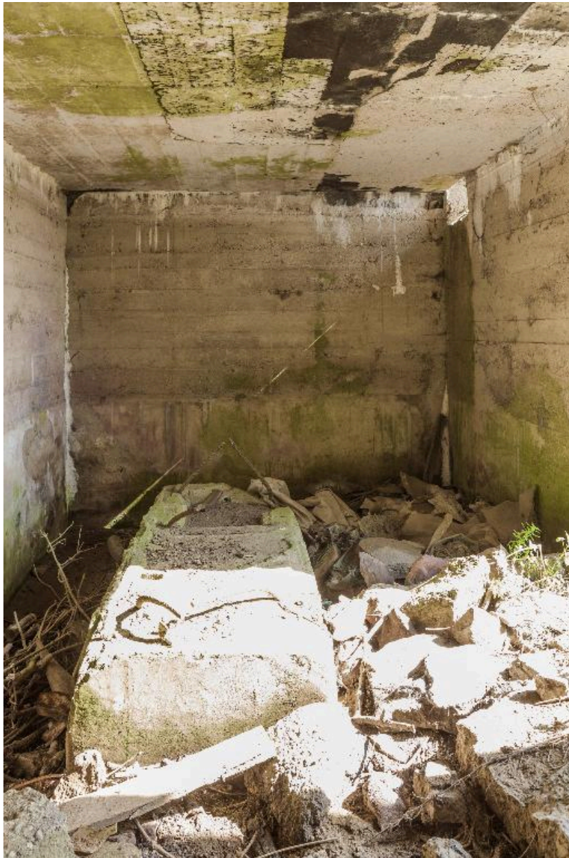
Bâtiment 2, massif bétonné des pompes
