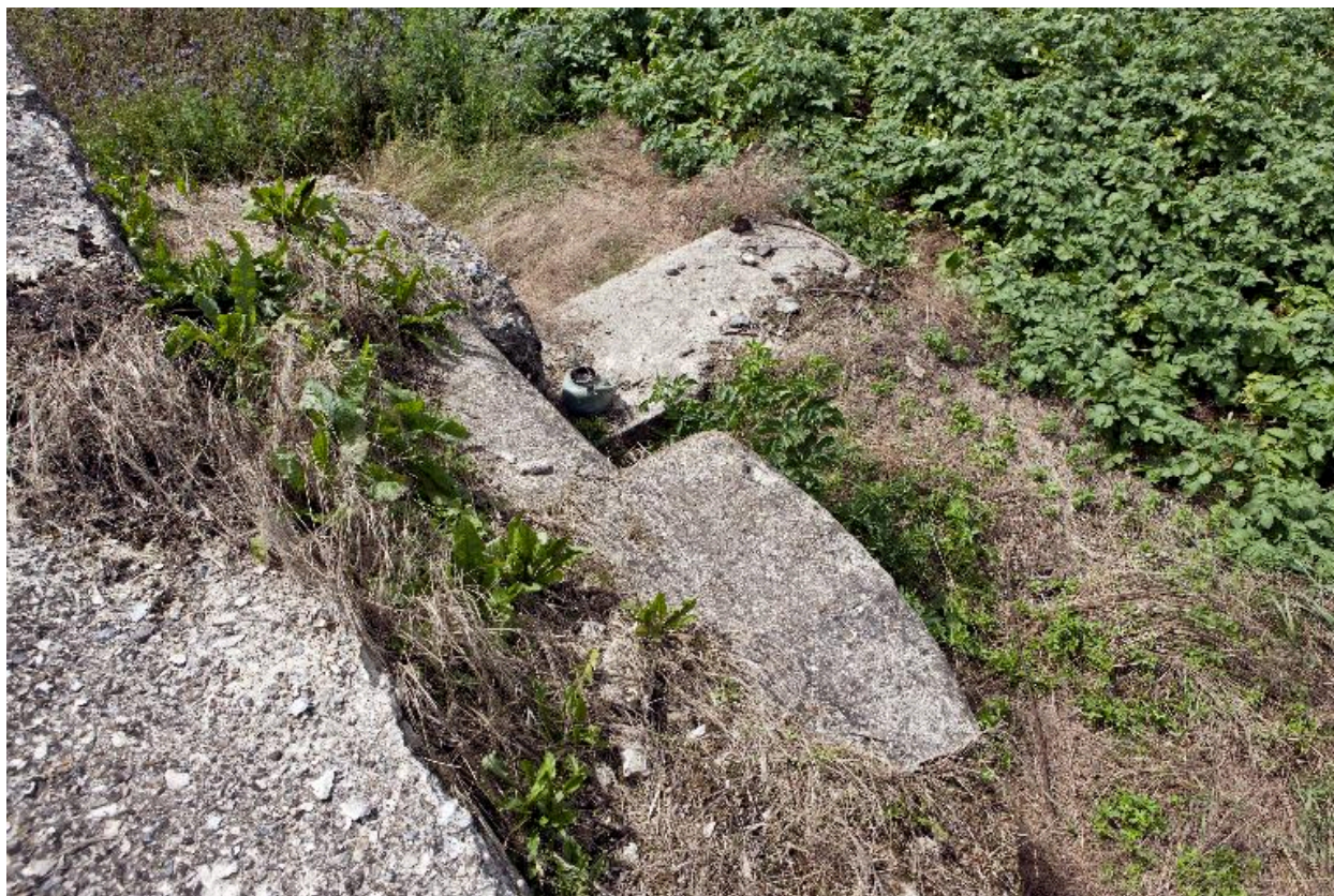
Vue de dessus du porche pare-souffle
