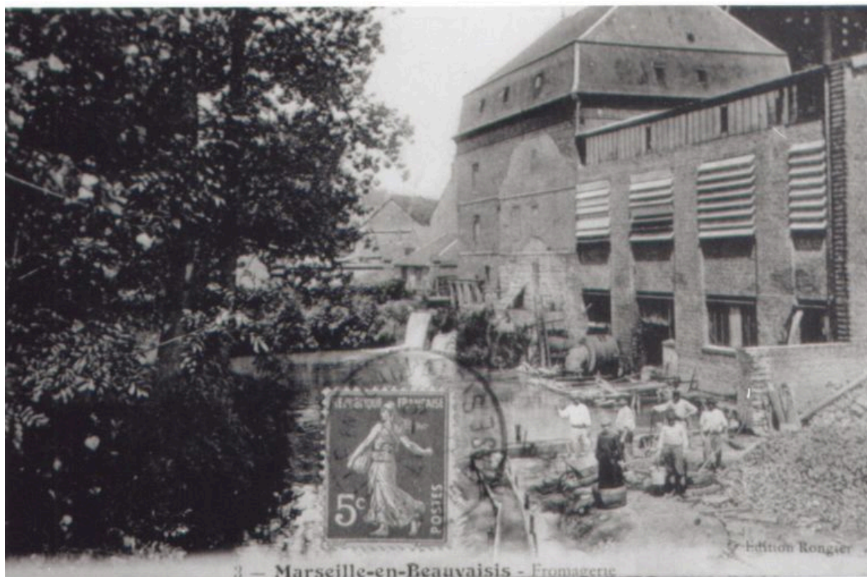
La fromagerie avec le haloir en cours de construction, vers 1908. (carte postale, collection particulière).
