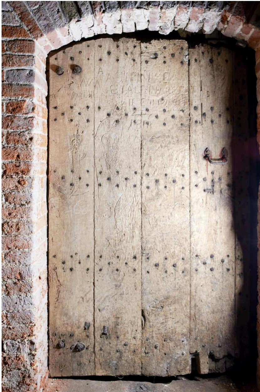
Niveau inférieur. Porte d'accès. Prise de vue générale en lumière rasante (xylographies).
