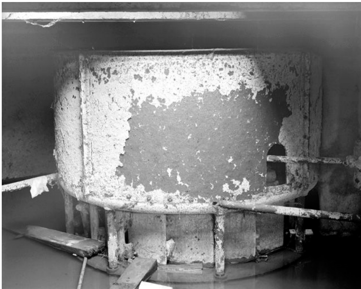
Bâtiment d'eau, turbine hydraulique.
