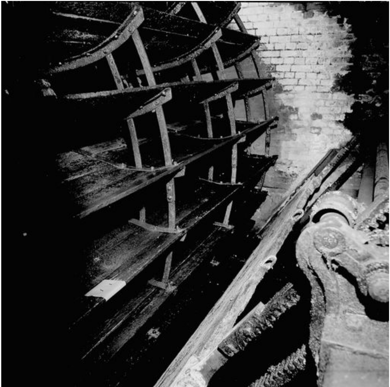
Vue de la vanne plongeante.
