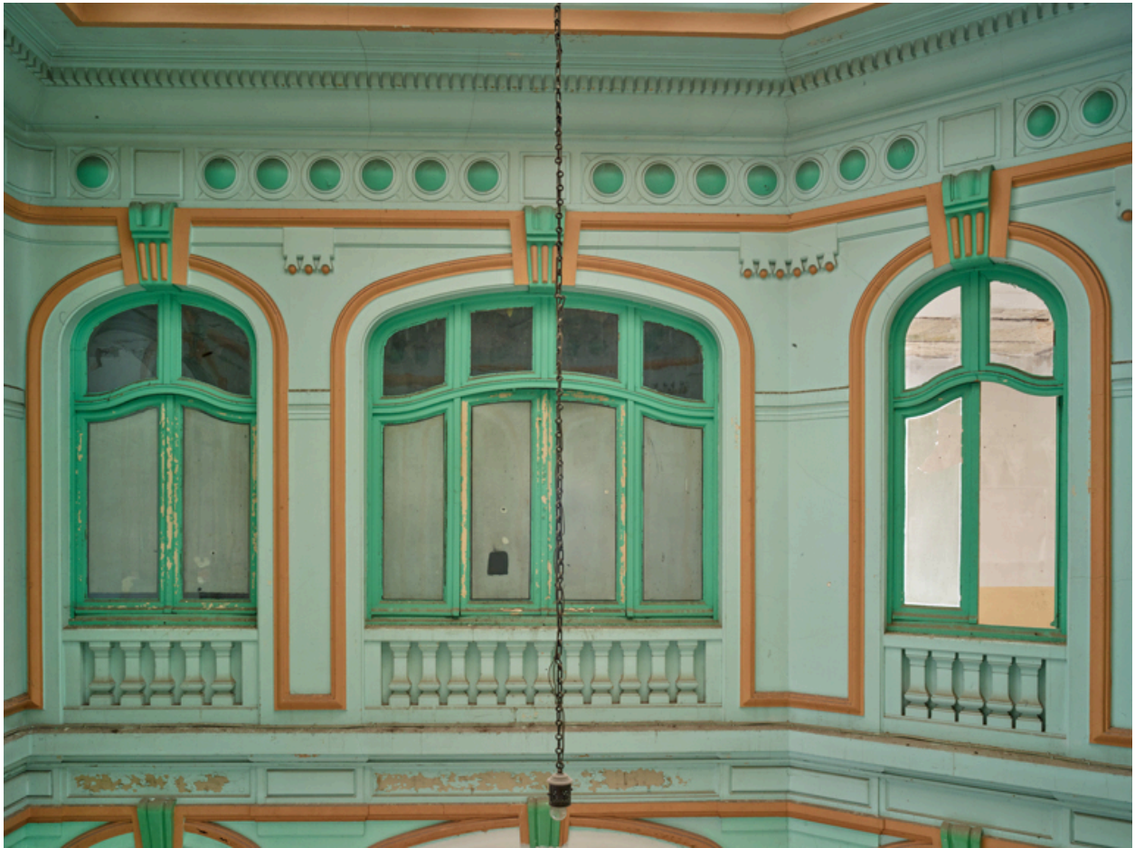
Bâtiment central. Détail du premier niveau de la partie sud du vestibule.
