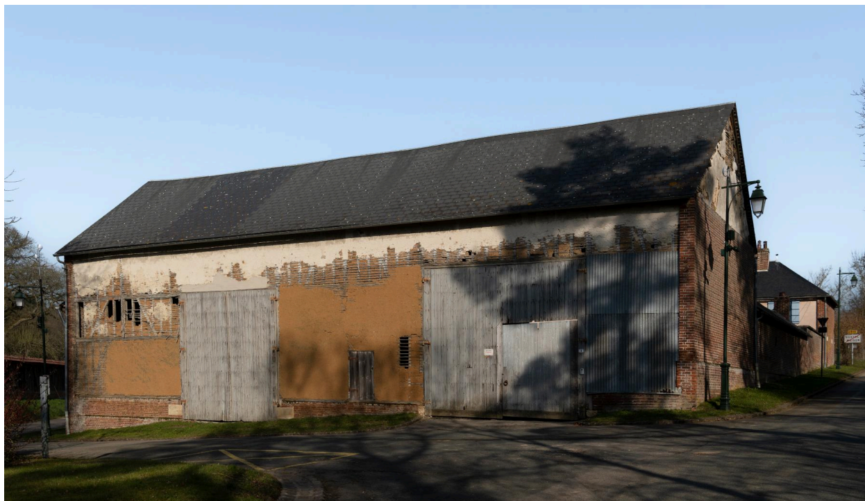
Grange de la ferme au n°9 de la rue du Presbytère, vue prise depuis le sud.
