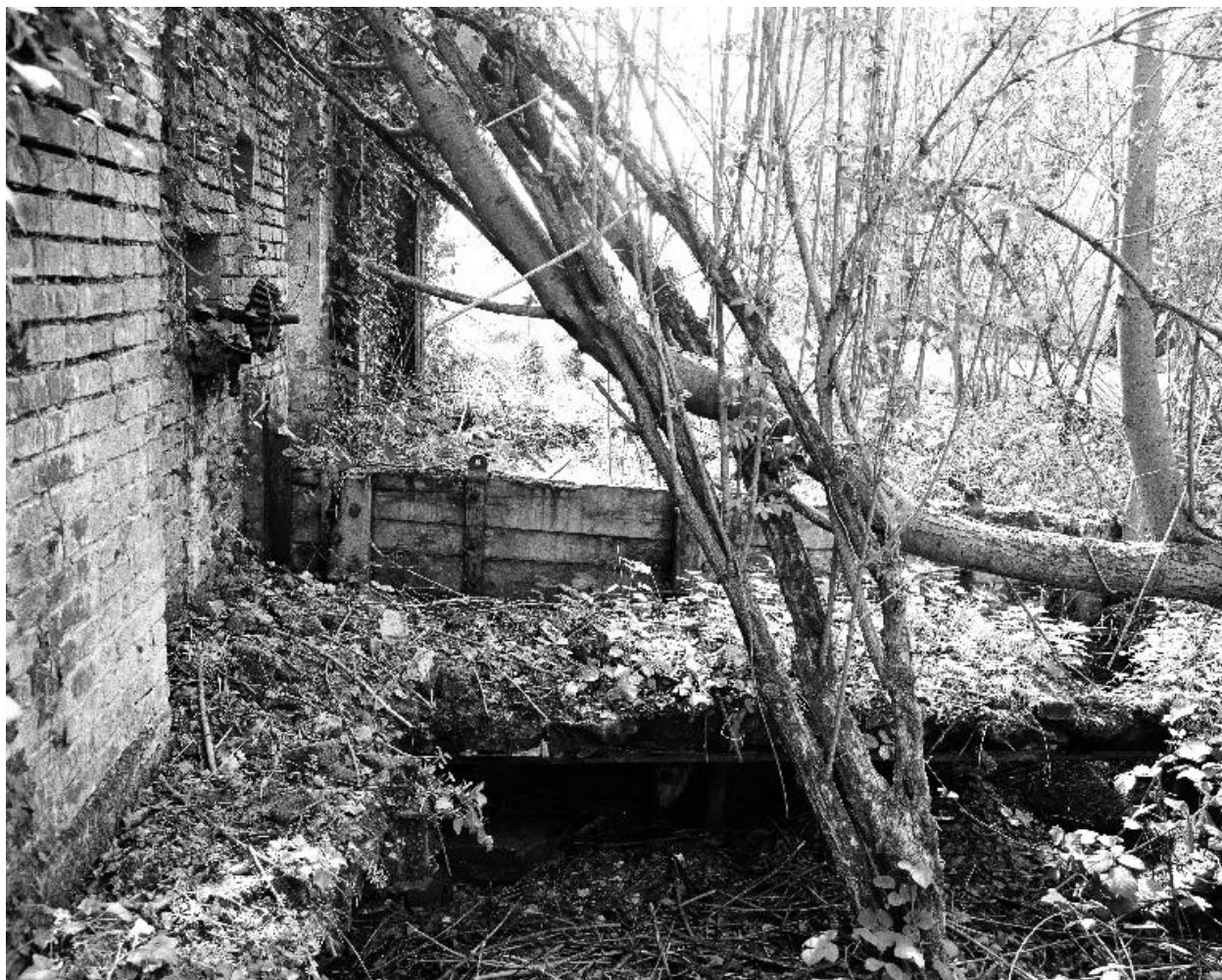
Vannes de décharge.
