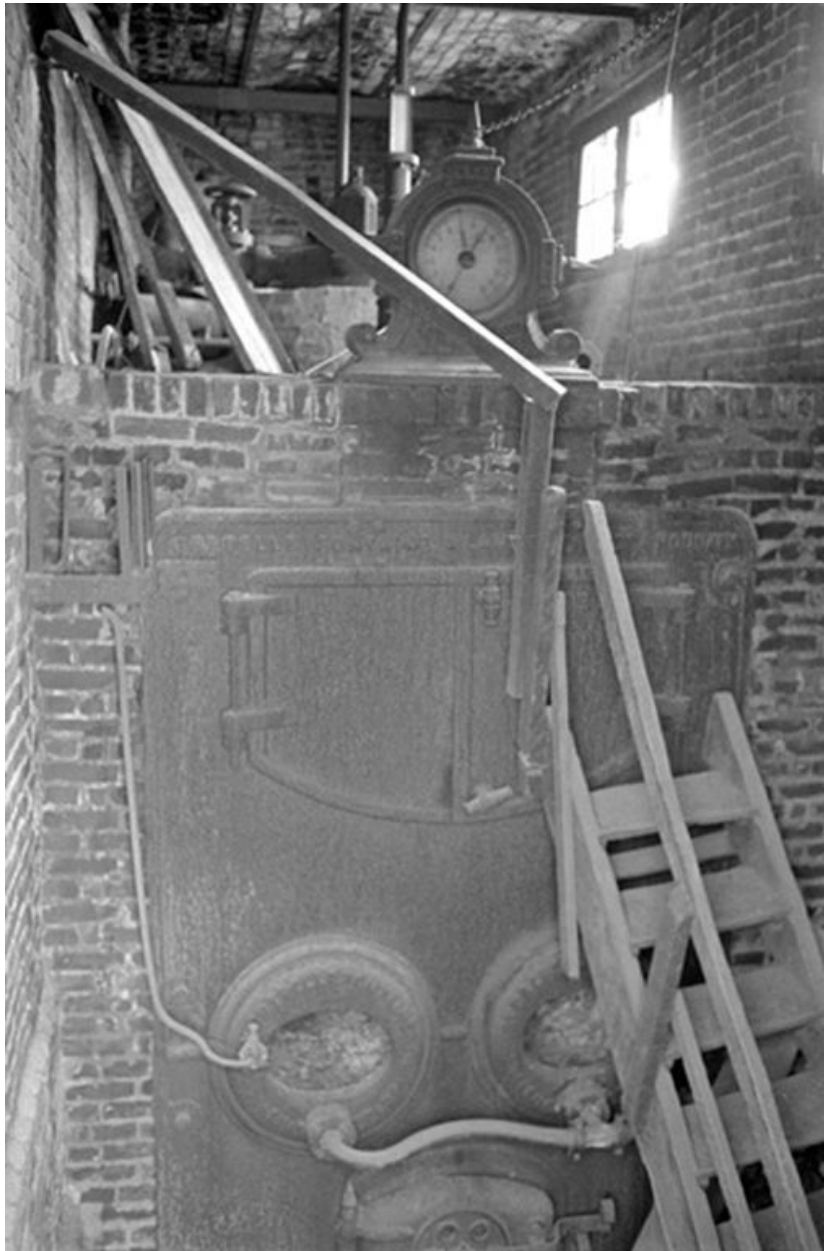
Chaufferie, vue intérieure : chaudière à vapeur (Crepelle-Fontaine), vers 1990.
