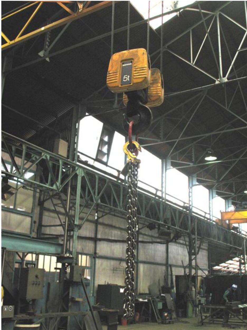
Grue de levage de 5 tonnes.
