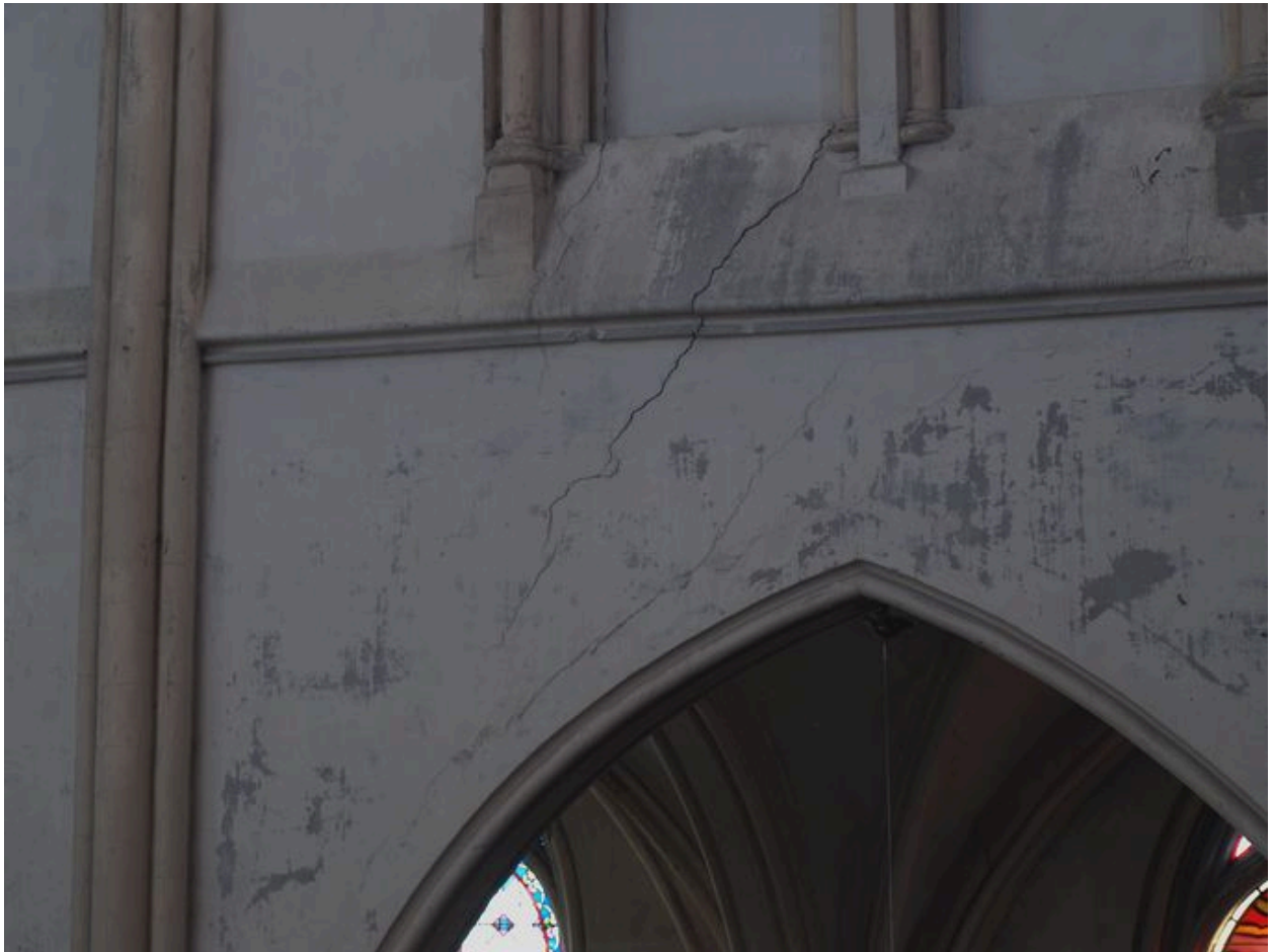
Haut d'une grande arcade (mur nord de travée ouest) : fissure en écoinçon
