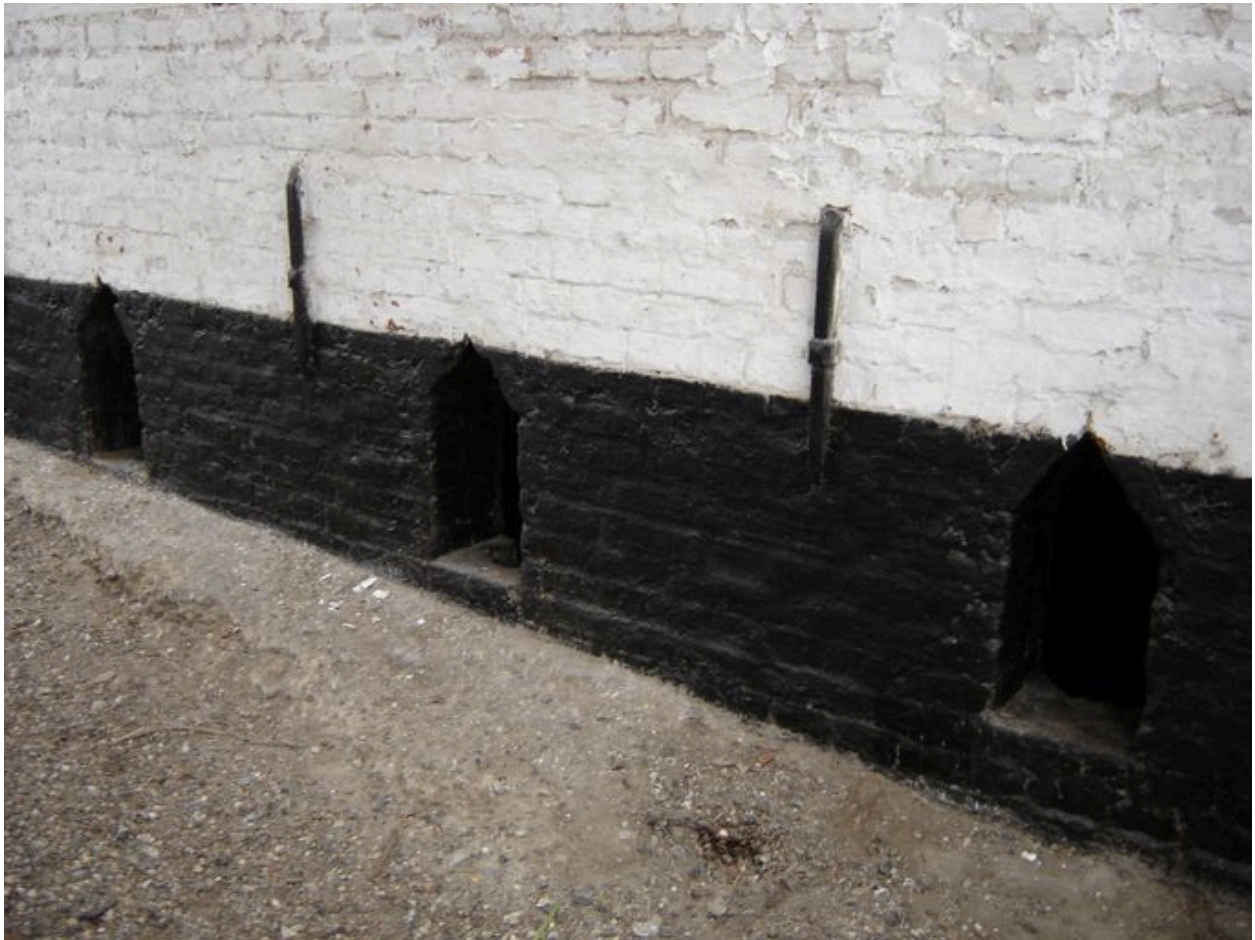
Détail des ouvertures de la cave pratiquées dans le solin du bâtiment sur rue.
