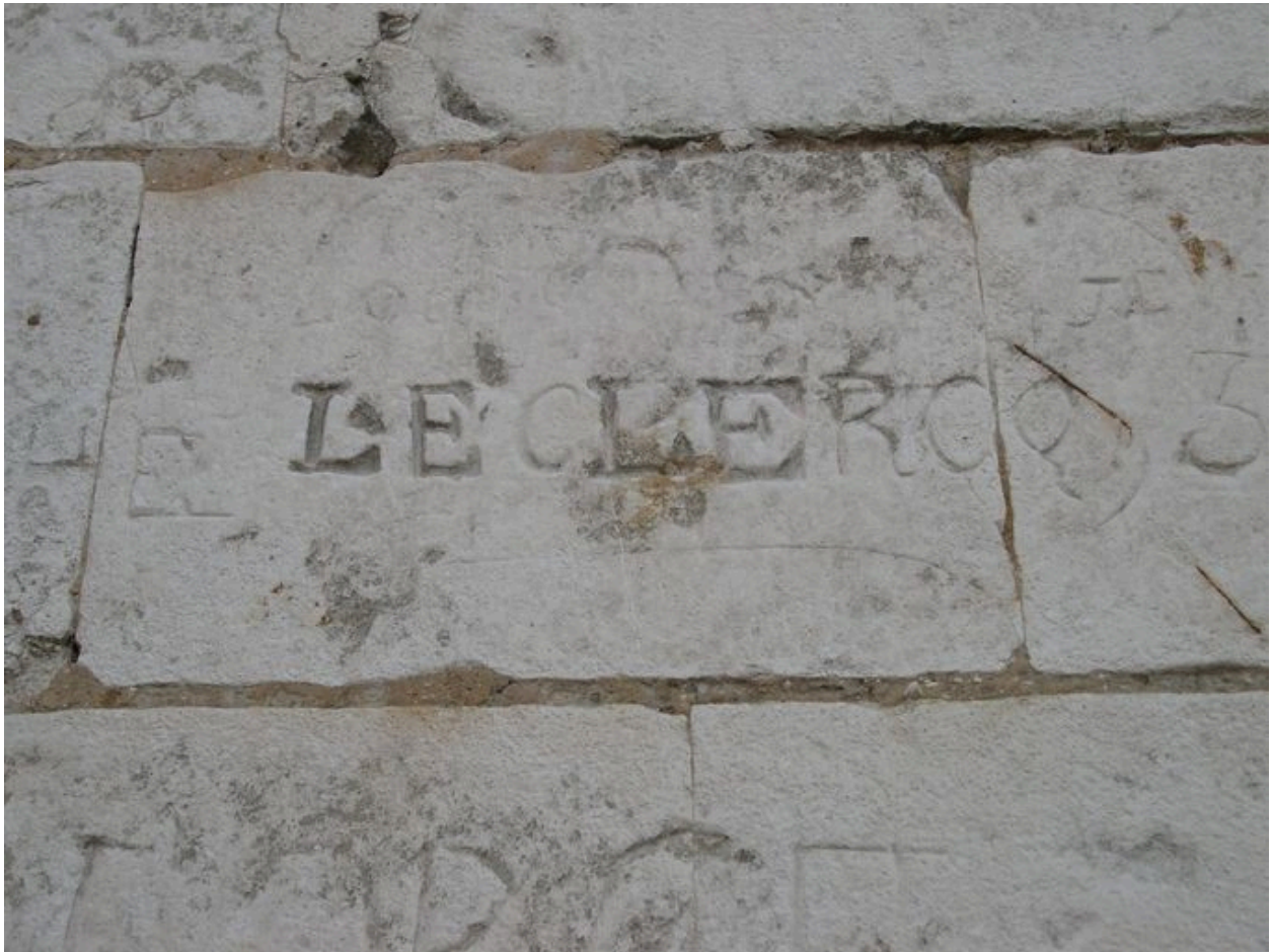
Mur nord du bas-côté nord : Graffiti.
