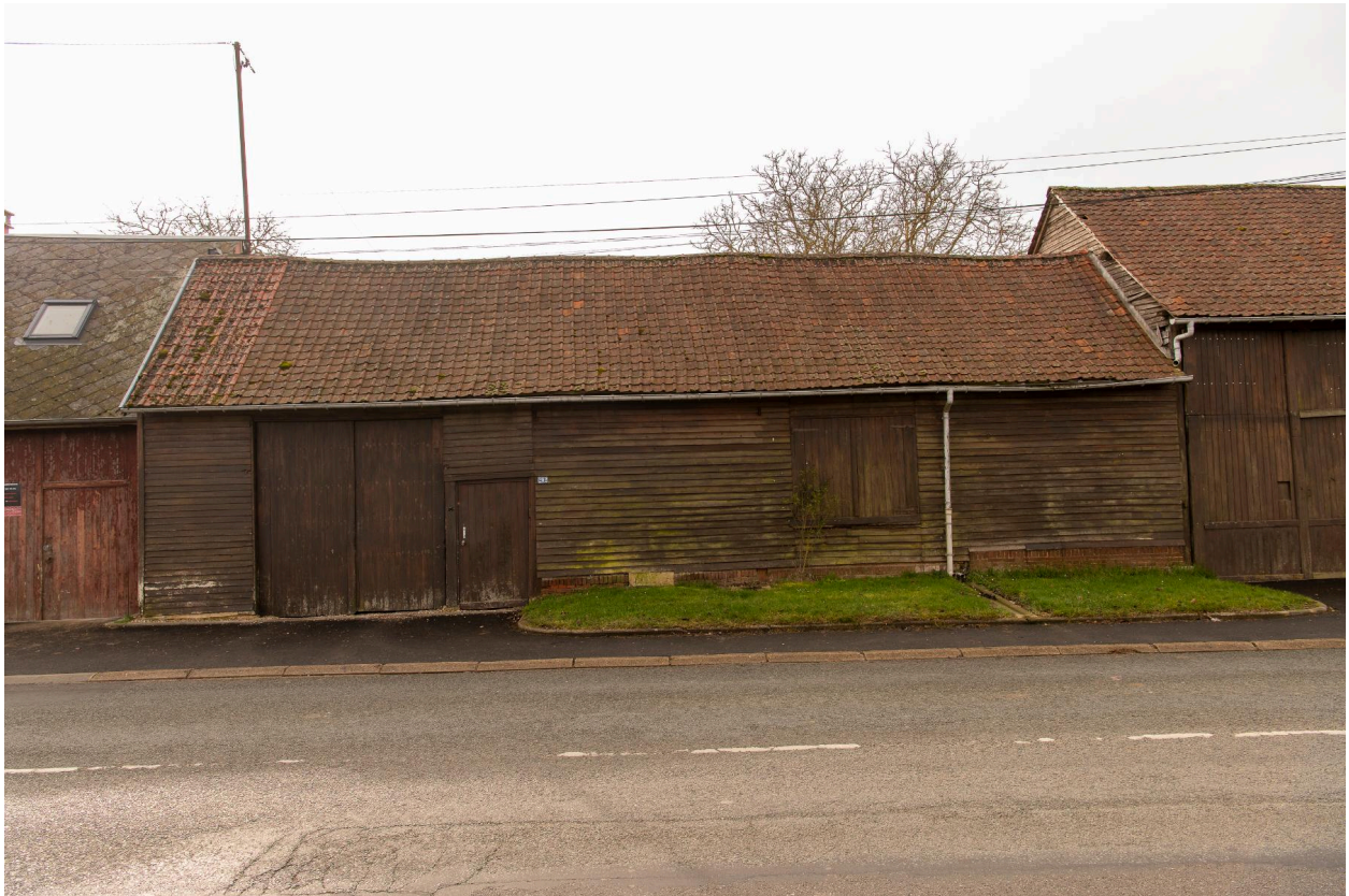
Grange sur rue avec entrée charretière, n°292 rue des Bouleaux, vue depuis le nord.
