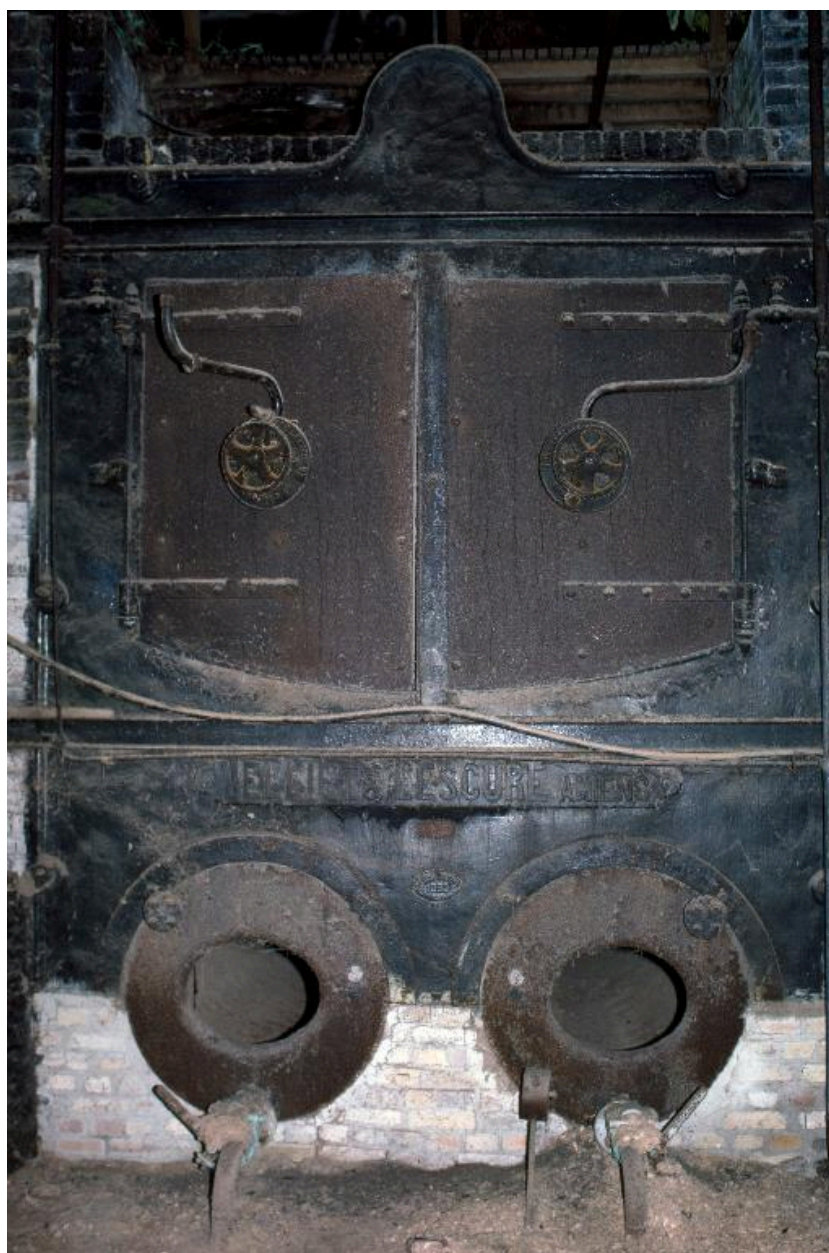
Chaufferie : chaudière Veilet Lescure.
