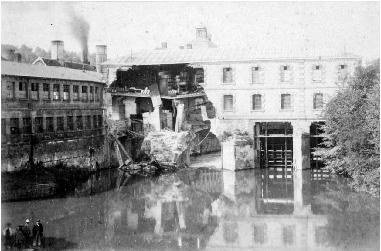
Effondrement d'une partie des bâtiments construits sur le petit bras de l'Oise, vers 1890 (musée Gallé-Juillet, Creil).
