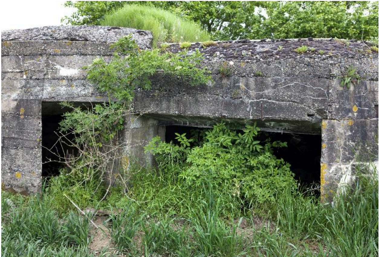
Elévation antérieure. Entrée de la chambre de tir, à droite et de la soute à munitions, à gauche
