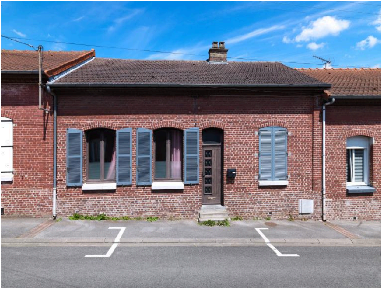
Vue de la façade d'un logement de la partie est de la cité.
