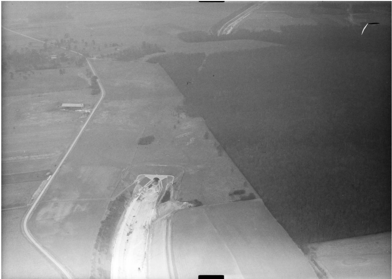
Vue aérienne de la tête sud du souterrain de la Panneterie en cours de restructuration, à proximité de Frétoy-le-Château (Oise), 1963.
