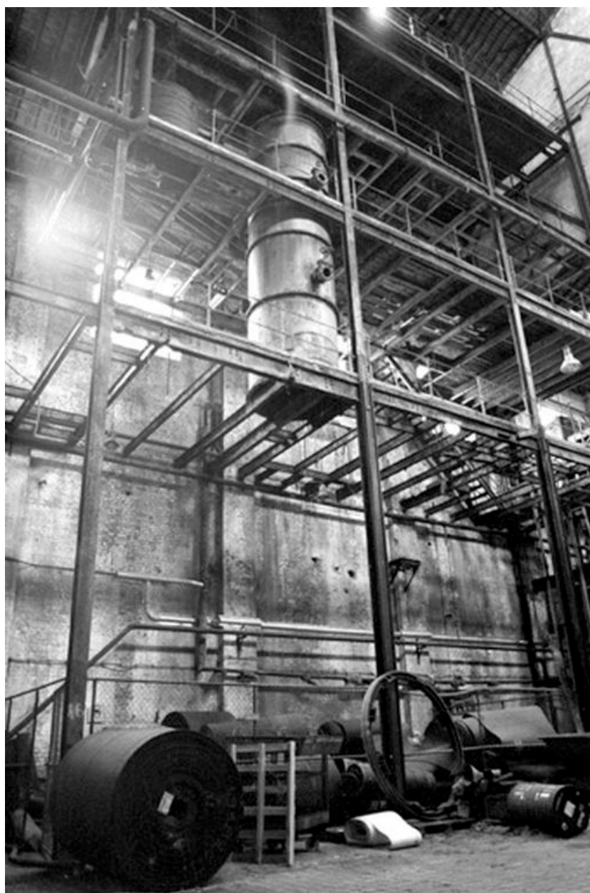
Chaudière, vue intérieure.
