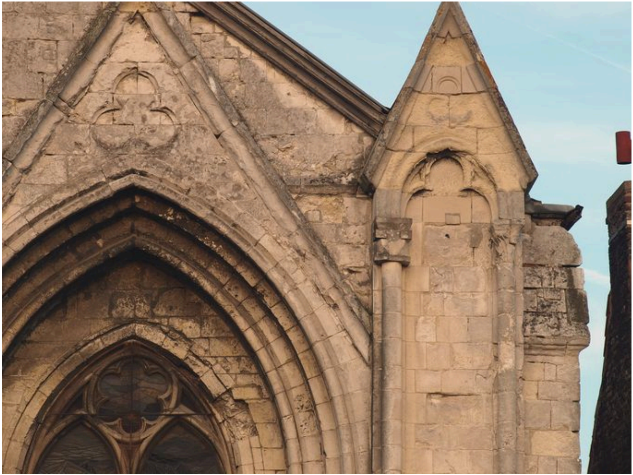
Gâble au-dessus de la fenêtre ouest du bas-côté sud et contrefort attenant : pierre érodée.
