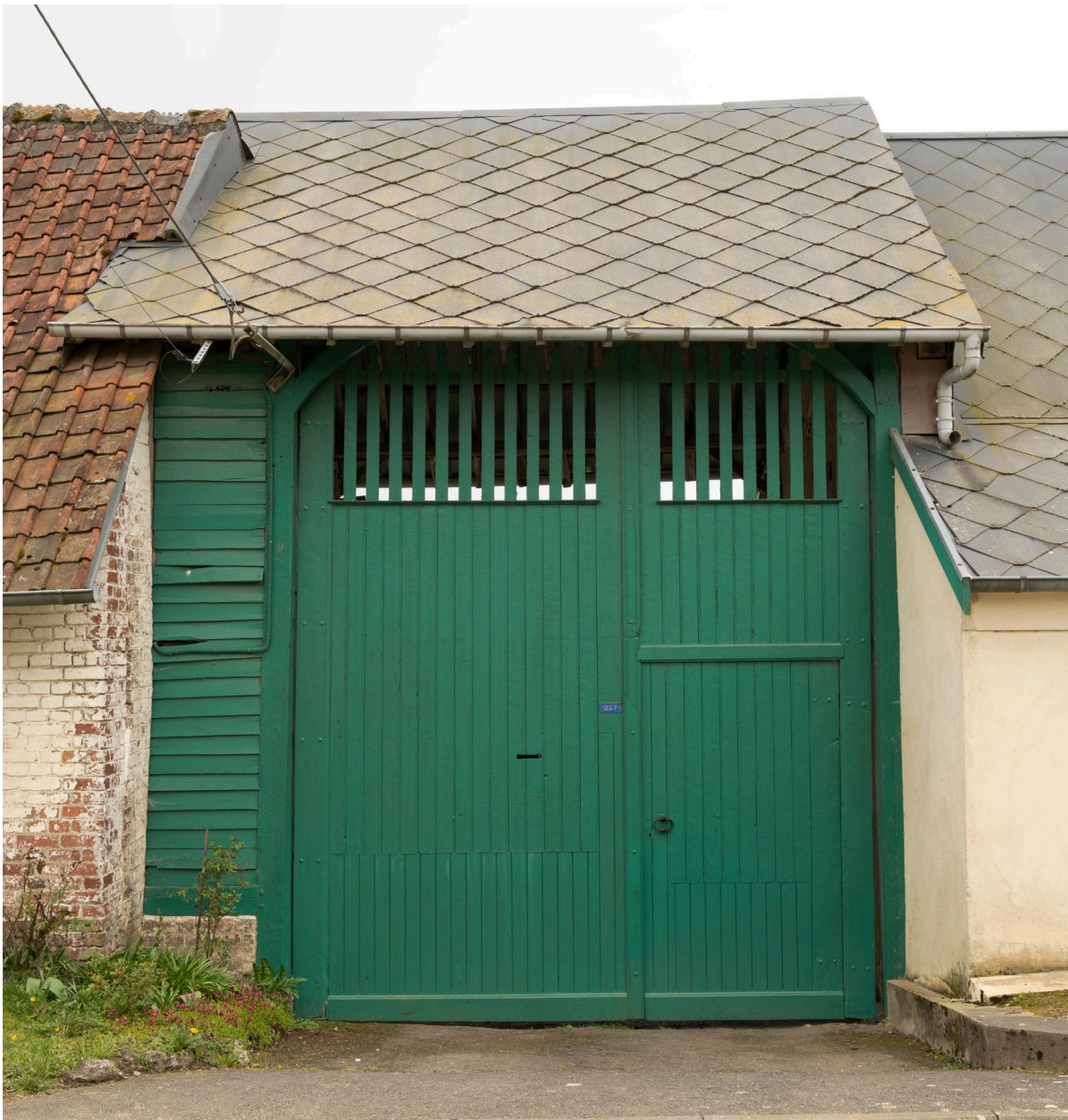
Entrée charretière, n°227 de la rue de Couvremont, vue prise depuis le nord.
