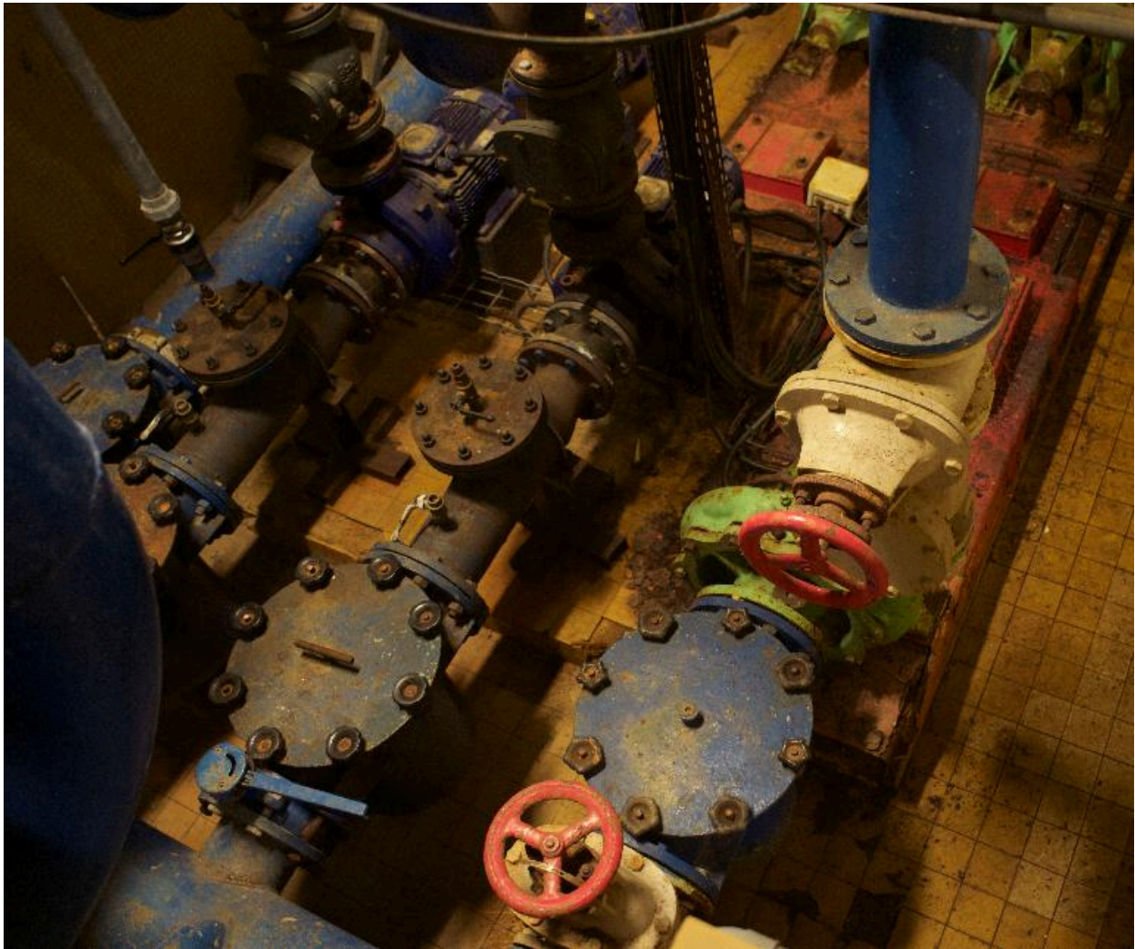
Vannes des bassins extérieurs.
